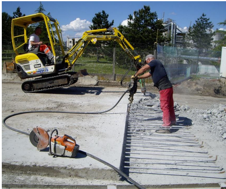
Photo 16 : Dégageant d'armatures de béton armé continu
