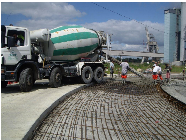
Photo 2 : Coulage du béton sur un giratoire en béton armé continu (Crédit photo : CMR Exedra)
