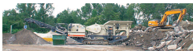
Exemple d'installation mobile
