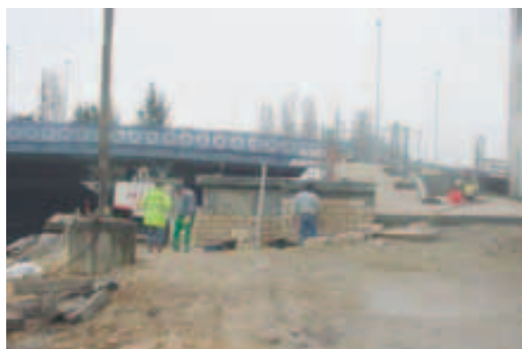
Habillage en pierres des murs de soutènement quai Galliot Stonework of Quai Galliot retaining walls
