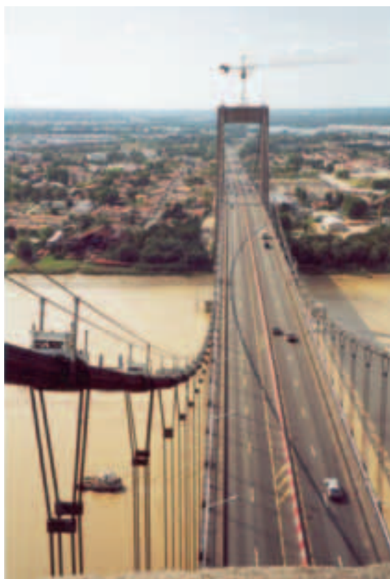
Photo 1 Vue du tablier depuis la tête d'un pylône View of deck from tower head
