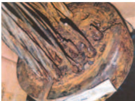
Photo 4 Tête d'ancrage du câble D5 Anchoring head, cable D5
