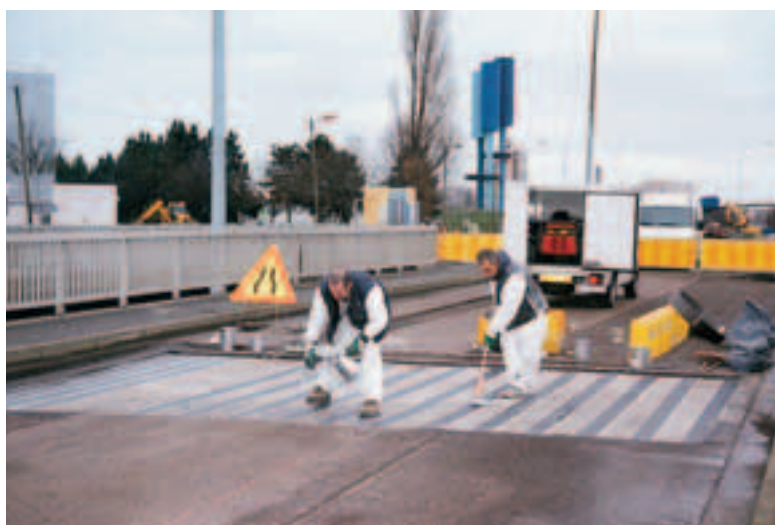
Photo 4 Application des lamelles Sika Carbodur en chapeau au-dessus d'une pile centrale Application of Sika Carbodur strips on capping over a central pier
