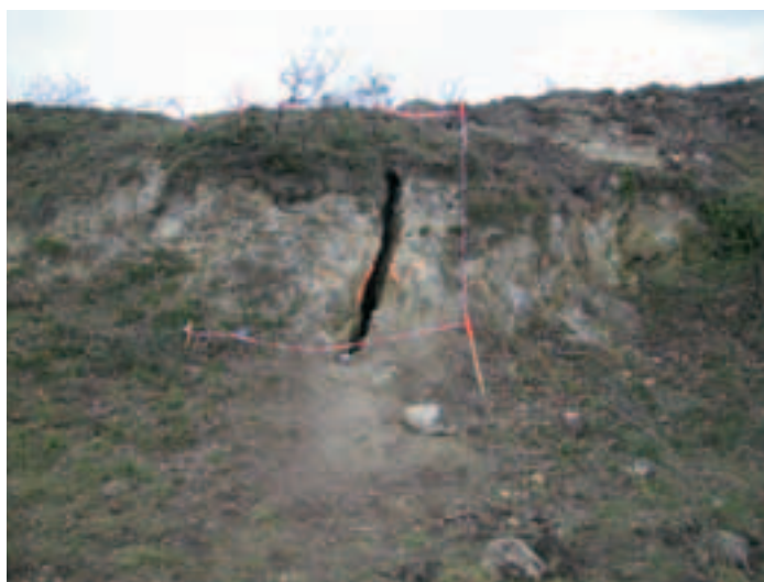
Photo 1 Fissure dans le talus routier (après déboisement) Crack in the road slope (after forest clearing)
