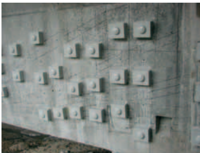
Photo 6 Vue extérieure des tiges de clouage du massif d'ancrage de la précontrainte additionnelle sur culée ; la position des câbles est dessinée sur l'âme
