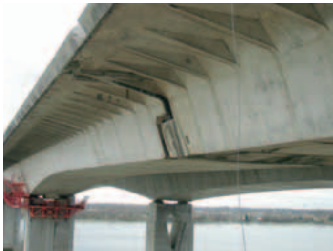
Photo 2 Vue extérieure du joint cantilever avant travaux External view of cantilever joint before works
