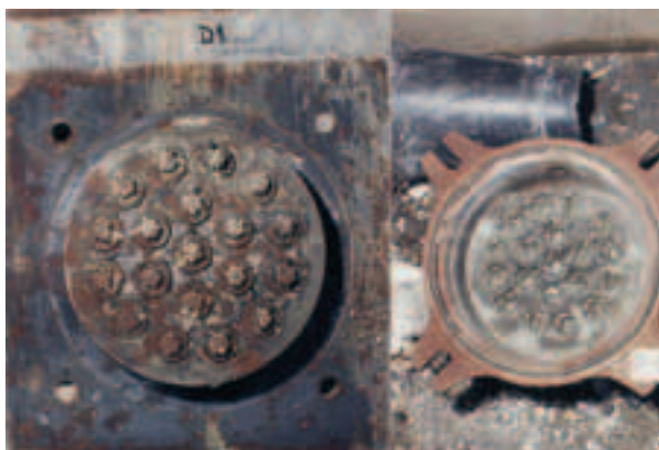
Photo 2 Etat d'une tête d'ancrage et de l'intérieur d'un capot Condition of an anchoring head and inside of a cover
