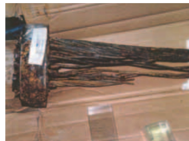
Photo 5 Tête d'ancrage et torons rompus du câble D5 Anchoring head and broken strands of cable D5
