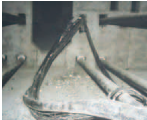
Photo 1 Rupture du câble D5 Broken cable D5
