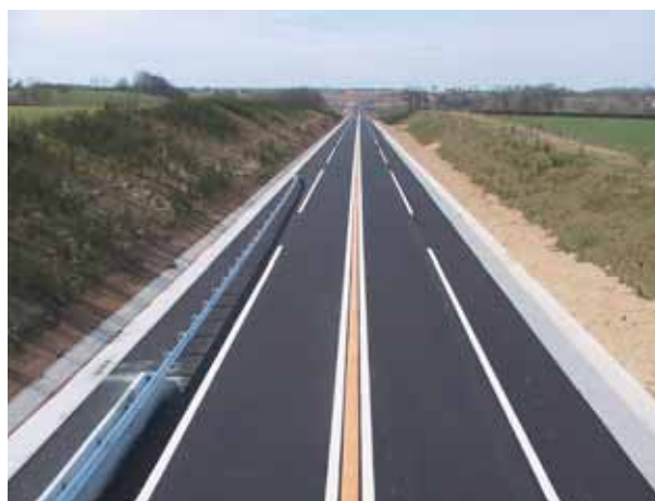
Fin mars 2003 : la couche de roulement est appliquée, la pose des équipements de sécurité (glissières, marquages au sol...) se termine End of March 2003 : the wearing course is applied, and installation of safety appurtenances (guard rails, road markings, etc.) is completed
