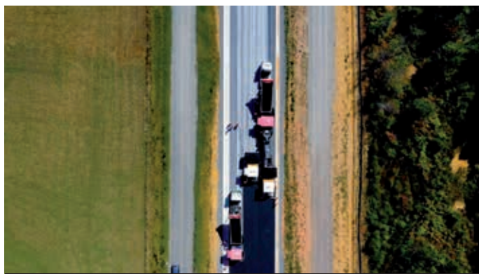
Le chantier de contournement de Sansac (15) sur la RN122 a été livré avec 2 mois d'avance.
